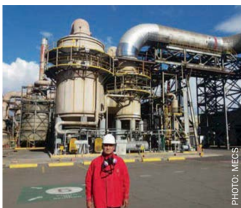
Mexicana de Cobre's La Caridad sulphuric acid plant.
