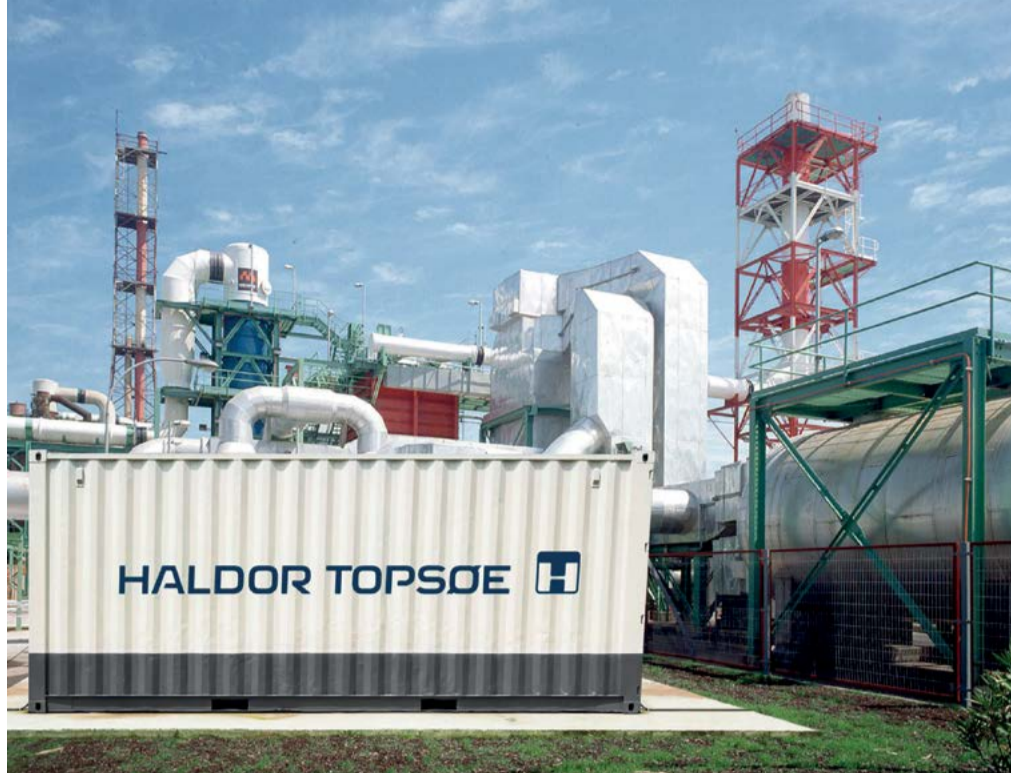
Topsoe modular CO unit.
