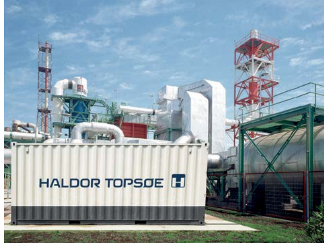
Topsoe modular CO unit.
