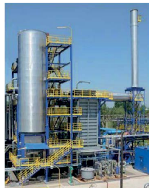
Topsoe WSA unit.
