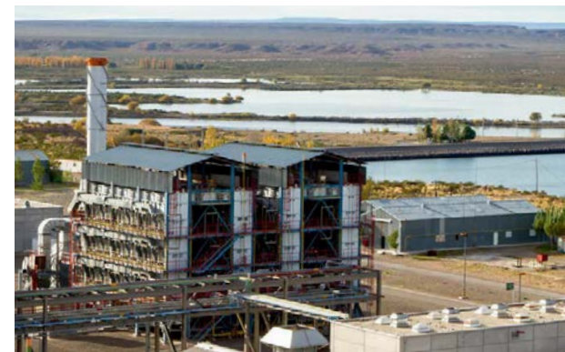
Fig. 2: 2,400 t/d ammonia cracker in Planta Industrial de Agua Pesada (PIAP) plant
